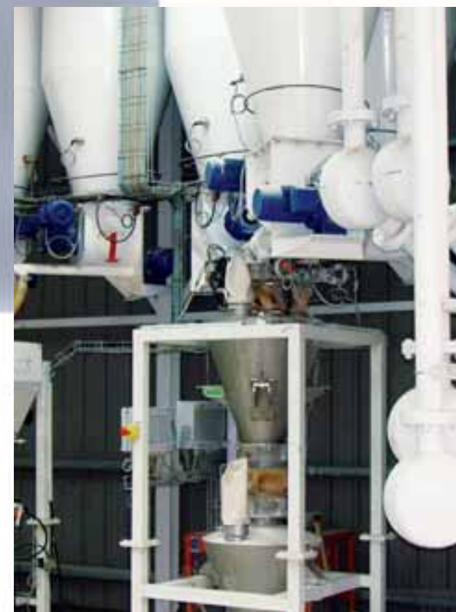
Instalación de dosificación de aditivos con doble sistema de pesaje por báscula de tolva y por báscula de volteo, 4 dosificadores por báscula
